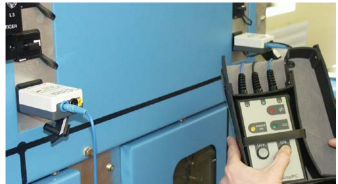
Einsatz des Phasenvergleichlers DEHNcap/PC-LRM mit zwei HR-LRM-Messadaptern an einer HR-Schaltanlage.
