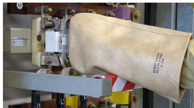
Betätigung einer NH-Sicherung mit NH-Sicherungsaufsteckgriff mit Stulpe.
