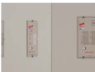
Erfassungsgeräte in der Tür
