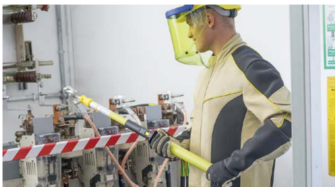
Anbringen einer EuK-Vorrichtung mit der notwendigen Schutzausrüstung.
