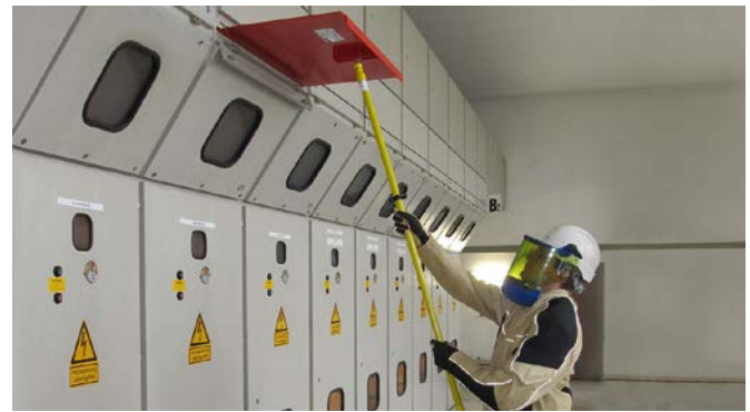
Einbringen einer Schutzplatte der Bauform A3 mit Arbeitsstange.
