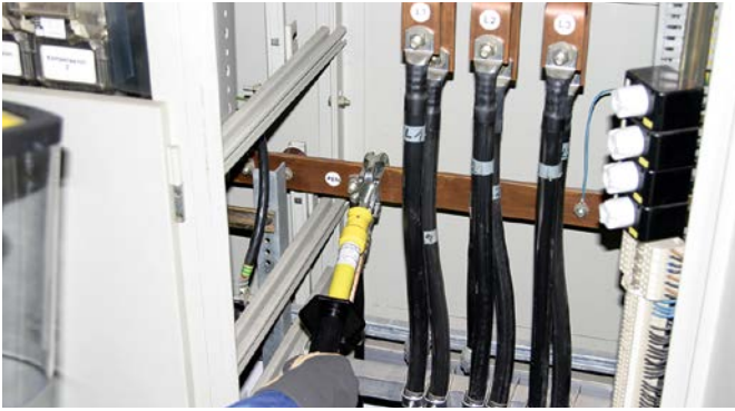
Einbringen einer Erdungs- und KurzschlieÙvorrichtung mit dem Erdungsgriff in einer Niederspannungsschaltanlage.
