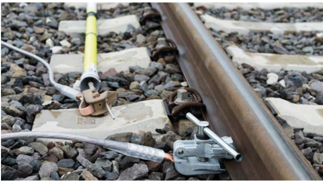
Schienenanschlussklemme am Schienenprofil montiert.
