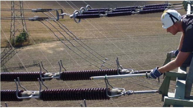
Hochspannungsanzeiger an einer 110 kV-Freileitung.
