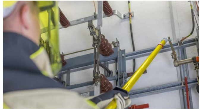
Betätigung eines Lasttrennschalters mit der Schaltstange SCS.
