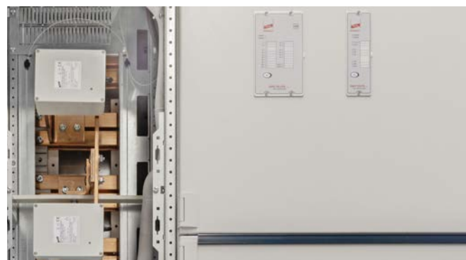
Aktives Störlichtbogenschutzsystem DEHNshort eingebaut in einer Schaltanlage.
