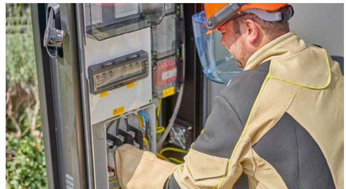
Wartung von Ladesäulen.
