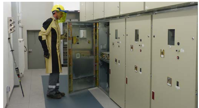
Schaltraum mit ausgelegter Isoliermatte 50 kV.
